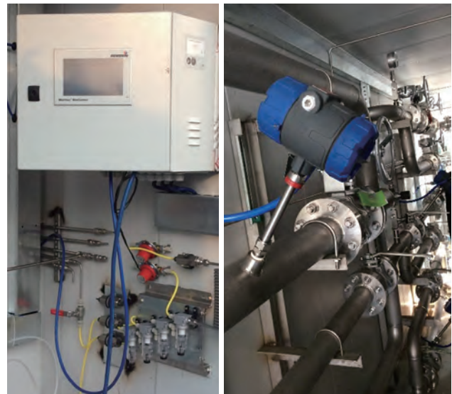
Installierte Geräte-Kombination aus stationärer Einheit und mobilem Mehrgasmessgerät (links); integrierter Durchfluss- und Temperaturtransmitter (rechts)
