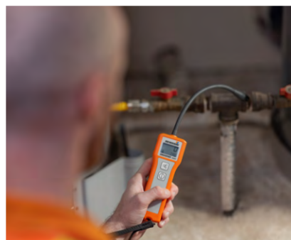
Contrôle d'un système de chauffage
