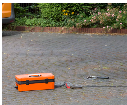
Localisation acoustique de conduites principales
