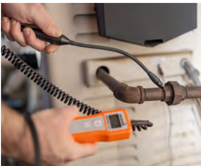
Überprüfen einer Gas-Poolheizung
