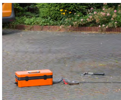
Akustische Ortung von Hauptleitungen
